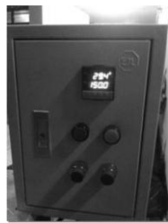
รูปที่ 4 ตู้สวิตช์ควบคุม
